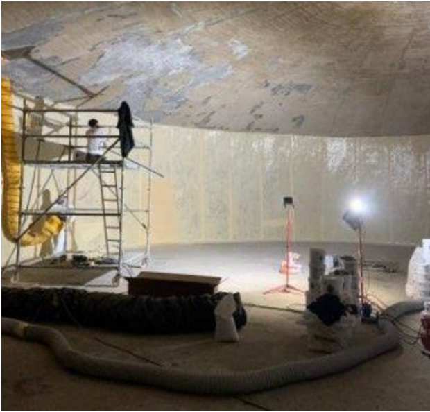
Reprise de l'étanchéité des voiles à l'intérieur de la cuve du réservoir
