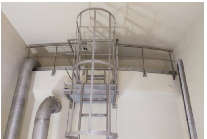
Pose d'équipements (échelle à crinoline, garde-corps,...) permettant un accès sécurisé à la cuve depuis la chambre des vannes
