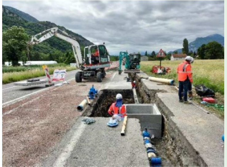
Pose de la conduite principale en Fonte le long de la RD1075 avec création d'un regard de sectorisation
