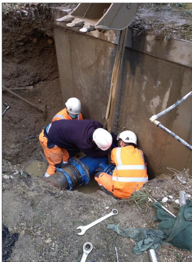
fuite conduite 250 mm bache de Sambuis Voreppe
