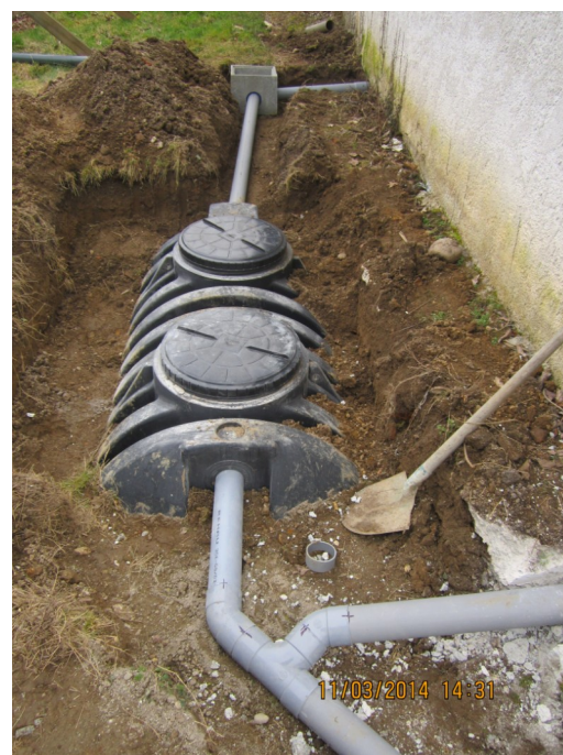
Fosse toutes eaux
